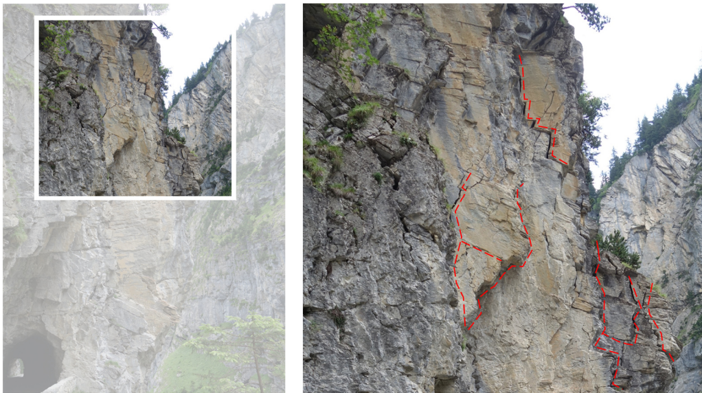
Ilustración 18: Análisis de las superficies rocosas – En el lado derecho de la foto hay una sección ampliada de una cara de la roca a la entrada de un túnel. La orientación de las fisuras (líneas rojas) definen los diámetros de las piedras de caída. Fuente: CRS.
